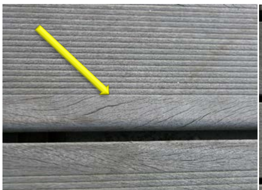
Cumarú med många små sprickor Foto från inspektionen i oktober 2018
