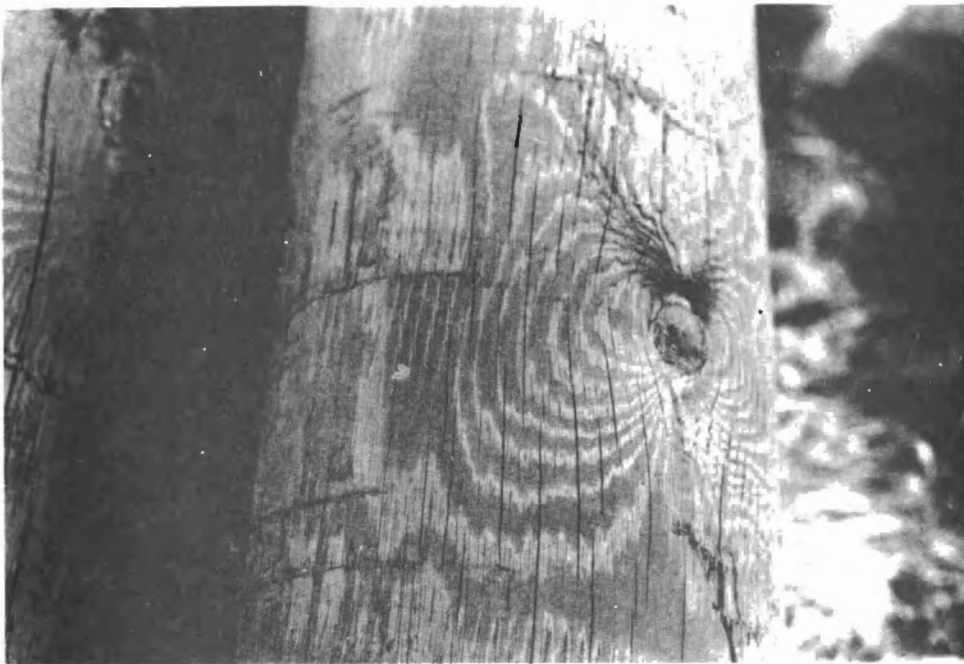
Figur 12. Exempel på ingen svettning Example of clean poles.
