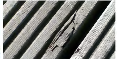
Typisk kantspricka på grund av materialets sprödhet i rillad bräda av värmebehandlat trä.
