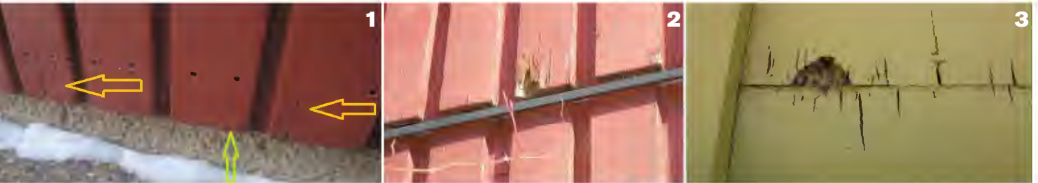
Typiska exempel på dåliga konstruktionslösningar: 1) Panel alldeles för nära marken (bör vara minst 30 cm), med begynnande rötskador, 2) Panel med för litet avstånd till droppbleck, 3) Stumskarv i panel.
