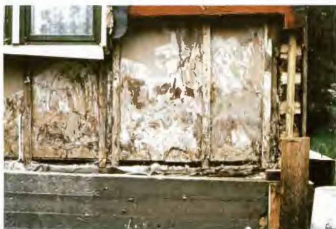
Fig 10. Hussvampen sprider sig ofta dold inne i väggar. På bilden ses kraftig mycelbildning, som frilagts i en yttervägg. Ursprungshärden låg i grunden, som hade byggts om på ett felaktigt sätt. Kryptrymmet hade fyllts igen och en ny grundmur hade gjutits, varvid de nedre delarna av träväggarna blivit inneslängda. Foto: Leena Paajanen, Statens Tekniska Forskningscentral, Finland.
