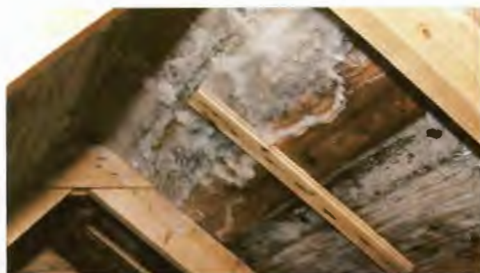
Fig 17. Starkt missfärgat virke med begynnande rötangrepp på insidan av taket i vindsutrymme. Husets ägare hade vid tilläggsisoleringen av vindsbjälklaget satt igen ventilationsspringan i takfoten. Dålig ventilation i kombination med varmluftsläckage från bostaden gav upphov till ett för missfärgande svamp, och senare rötsvamp, gynnsamt klimat. Foto: Svenska Träskyddsinstitutet.
