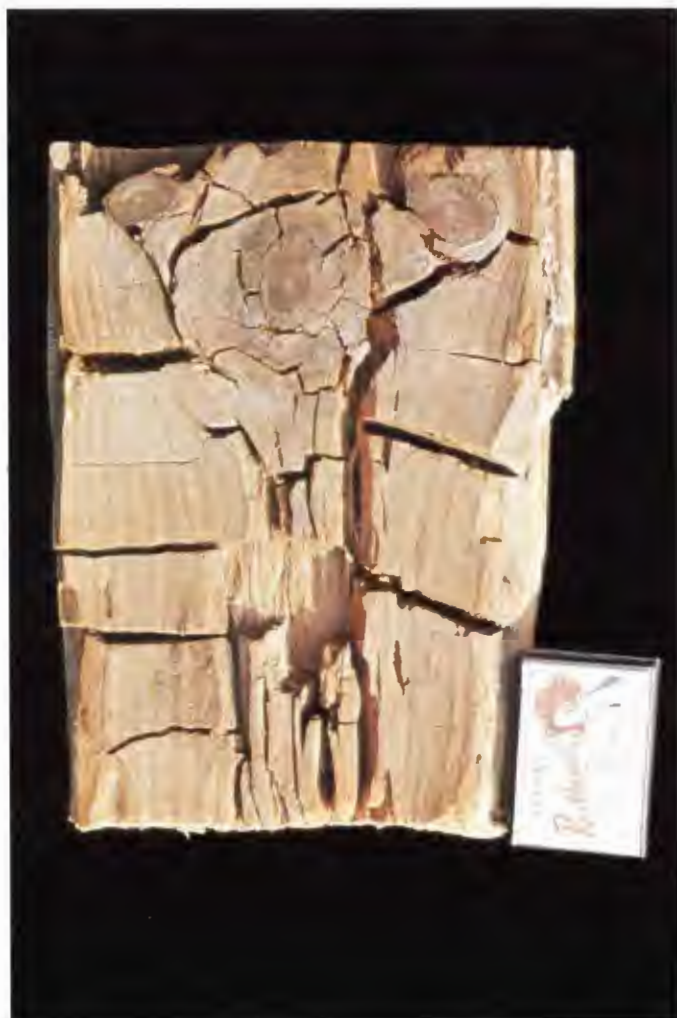
Fig 5. Hussvampen orsakar en typisk brunröta. Veden krymper vid torkning och spricker vinkelrätt mot fiberriktningen. Foto: John Thornton, CSIRO, Australien.
