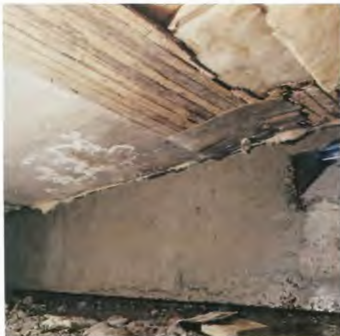
Fig 12. Angrepp av källarsvamp i blindbotten och bottenbjälklag. Fruktkroppsbildningar syns på blindbottens undersida mitt i bilden. Orsak till skadan var dels ett lokalt läckage av vatten utifrån, dels dålig ventilation av grunden. Foto: Lo Hertzman Ericson, Folksam.
