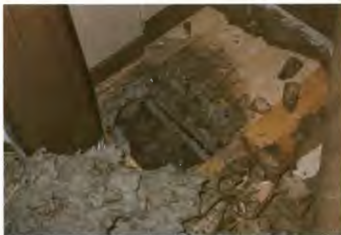
Fig 11 b. Sedan man rivit ut mattan och frilagt golvbräderna upptäcktes ett svårt angrepp av hussvampen. Nya golvbräder hade lagts in endast några år tidigare just på grund av ett rötangrepp. Man hade emellertid slarvat vid saneringen och underlåtit att åtgärda de verkliga orsakerna till skadan, nämligen dålig ventilation i grunden under golvet samt otillräcklig dränering. Detta medförde att vatten tidvis blev stående i grunden, och ett gynnsamt klimat uppstod för hussvampen. Foto: Hans Lundström.
